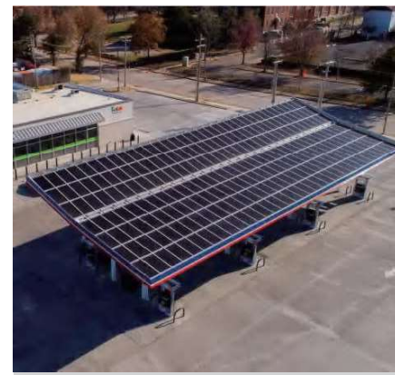
Projekt Tankstelle in Brazil 26kW
